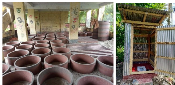
Photo 5 Latrines : matériel et unité construite
